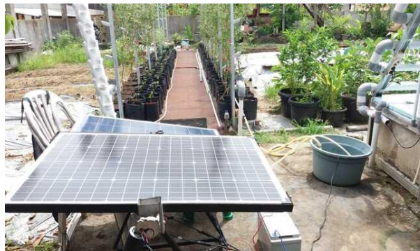
Gambar 2. Panel Surya sebagai Sumber Daya Pompa DC
