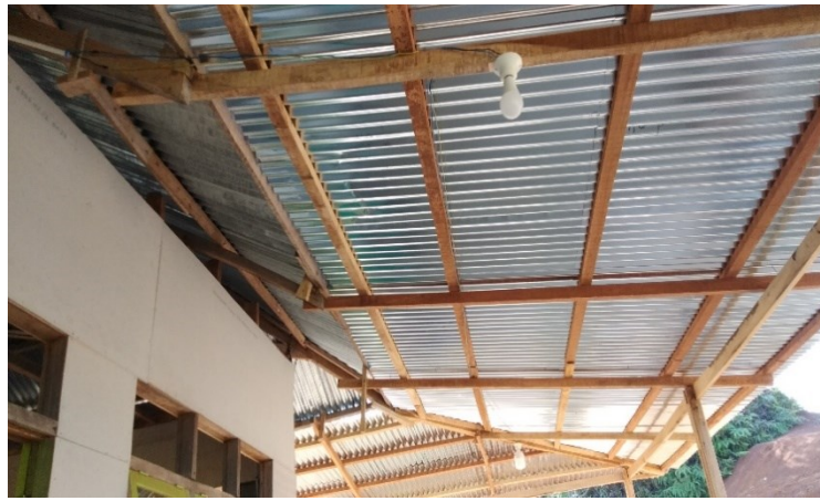
Gambar 1. Instalasi listrik yang tidak sesuai standar PUIL
