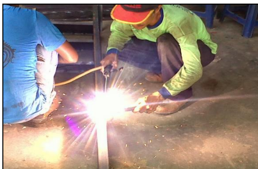
Gambar 3. Operator Maintenance Welding Tanpa Alat Pelindung Diri (APD) Lengkap
