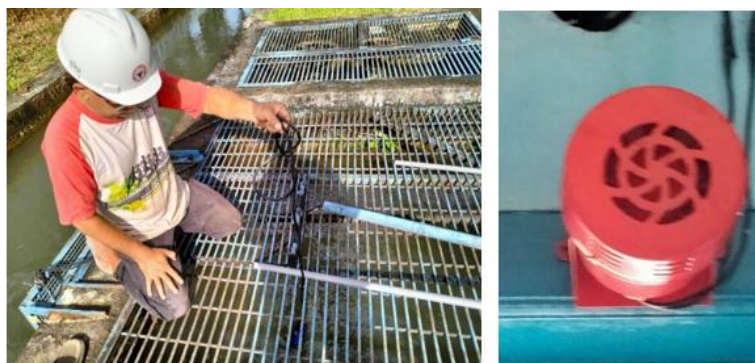
Gambar 6. Setelah Inovasi Kanal Air Bersih Sudah Terpasang Level Switch dan Alarm
